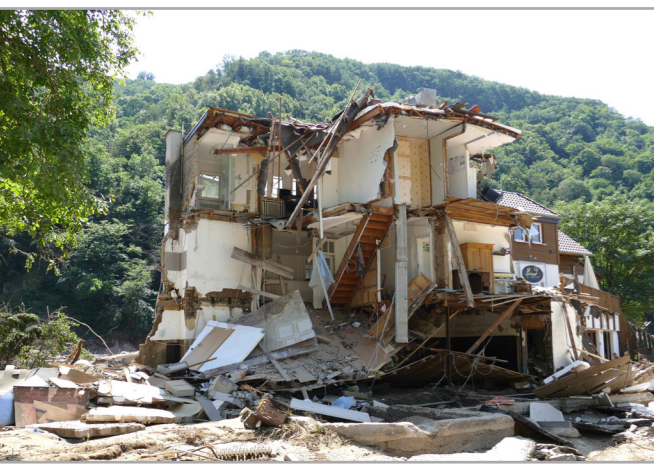
Zerstörtes Haus nahe Marienthal
