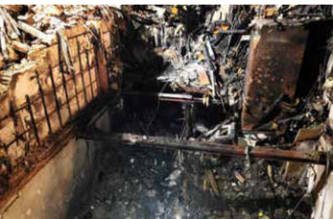
Frontalansicht des 2. OG nach Aushubarbeiten vom 14. September. Zu sehen ist die Decke des 1. OG, die Kommwand zum linken Nachbargebäude und der Fahrstuhl des Fahrstuhls. Die gleiche Ansicht als Wärmebild: Gut erkennbar sind Glutnes-ter im linken, hinteren Bereich des 2. OG.
